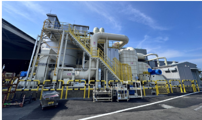
스마트팩토리 고용량 RTO(Regenerative Thermal Oxidizer) 설비
